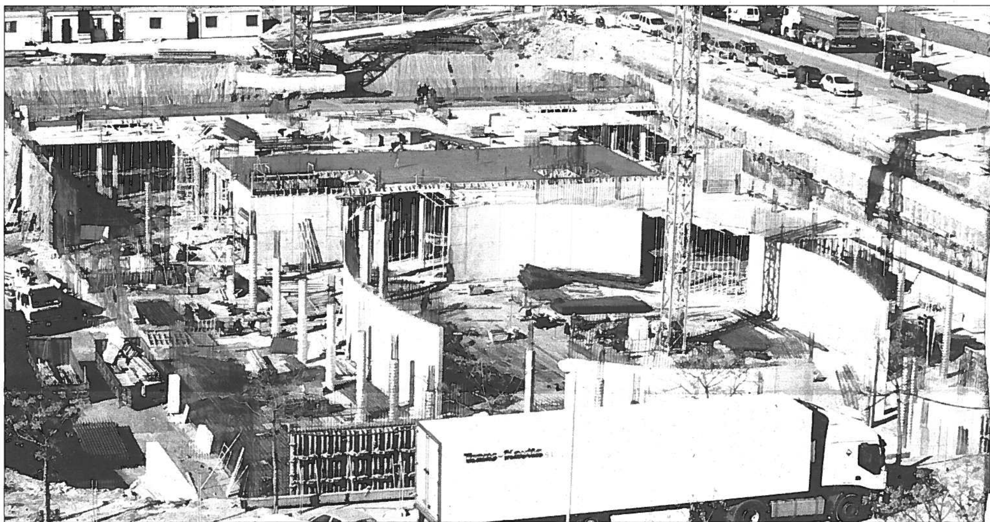
Estado actual de las obras. En el centro, el patio elíptico sobre el que se estructura el resto del centro. JUAN PALMA
